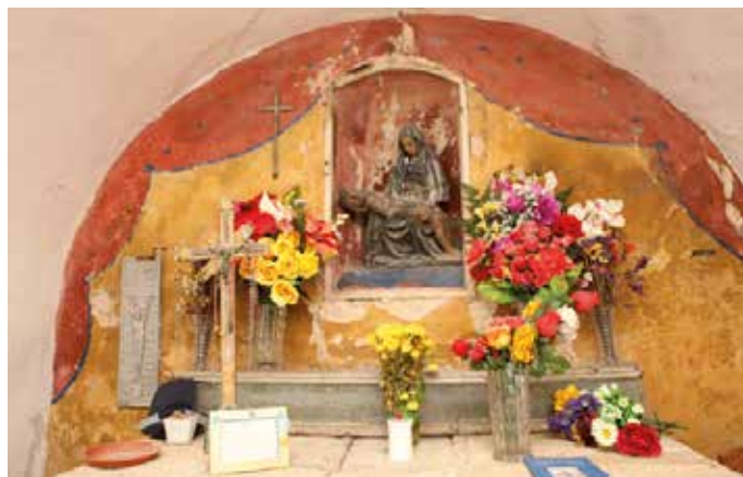
Castelsantangelo sul Nera: la chiesa della Cona, dopo il terremoto
